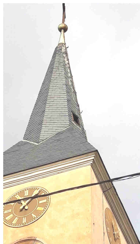
10 février : Suite aux vents violents, la lucarne du clocher de l'église s'est envolée;
